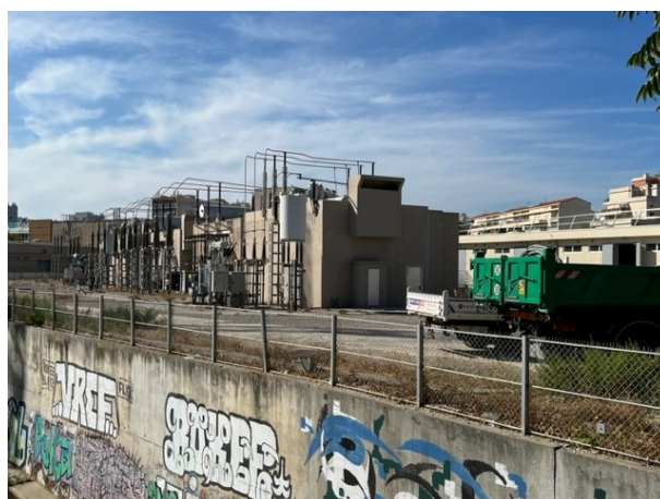
Les transformateurs électriques situés le long du bâtiment
